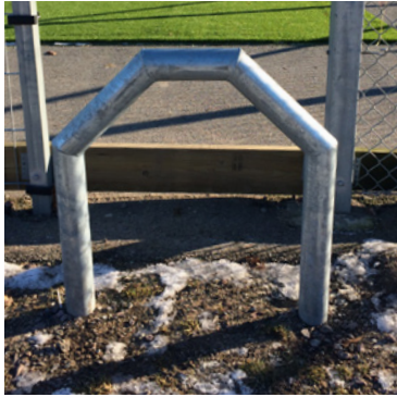
Monterat som hinder vid gångfälla till bollplan
